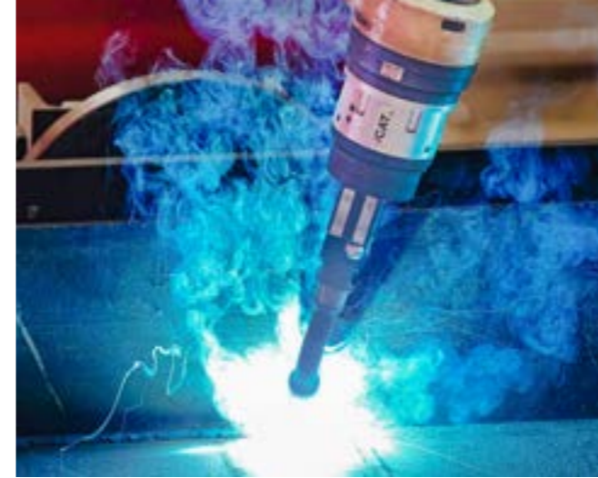
Rauchentwicklung beim Schweißen gefährdet die Gesundheit. | Welding fumes are a hazard to health.
