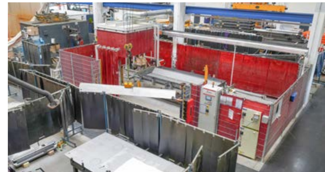
In Aktion: die neue Roboterschweißzelle im Werk 2. | In action: the new robotic welding cell in Production Facility 2.
